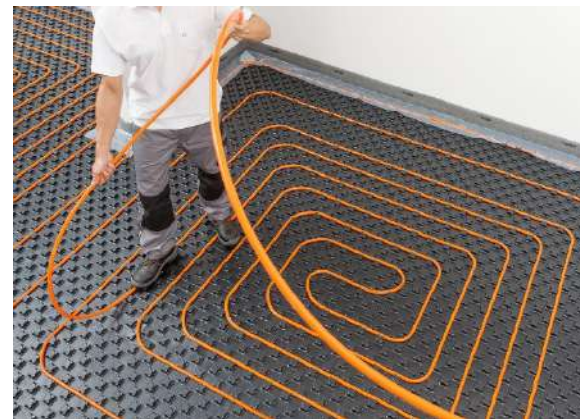
Suelo radiante hidráulico
